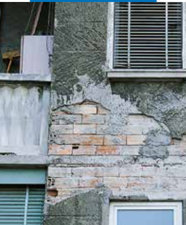
Pastato fasadas reikalaujantis remonto
